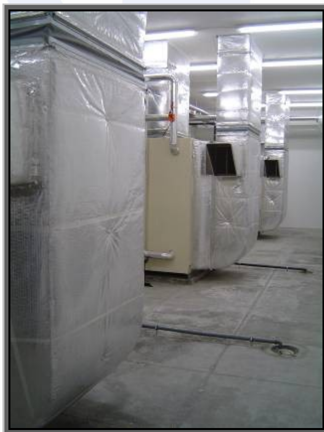
Central de tratamento do ar
