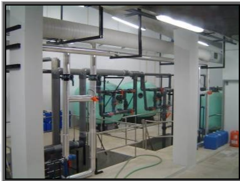
Central de tratamento de águas
